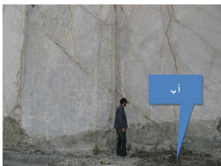
شکل ۱۶. نمایی از درز J15 چنان‌که در تصویر مشخص است در اثر تراوش آب در راستای صفحه درز، تجمع آب در پای پله صورت گرفته است (دید به سمت شمال خاور)
