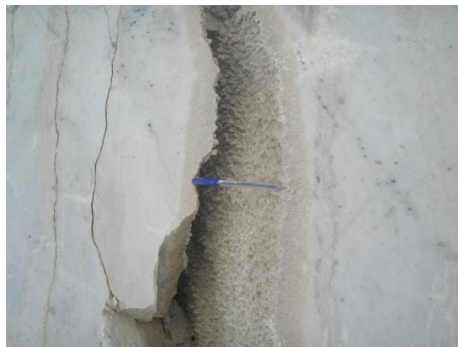
شکل ۸. تصویری از درز J10، این درز دارای دو نسل پرشدگی است و در حال حاضر در حال باز شدن است
