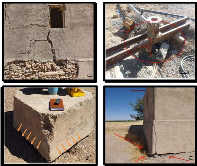
شکل ۹. الف) فرونشست سطحی در جداره لوله چاه بین دشت قروه و دهگلان (ب) ترک خوردگی در دیواره خانه چاه روستایی کروندان (ج) نمایان شدن فرونشست در حاشیه خانه‌های مزرعه روستای کروندان (د) پایین رفتن سطح زمین و ارتفاع یافتن پایه‌های نمونه پایش فرونشست در روستای شهابیه
