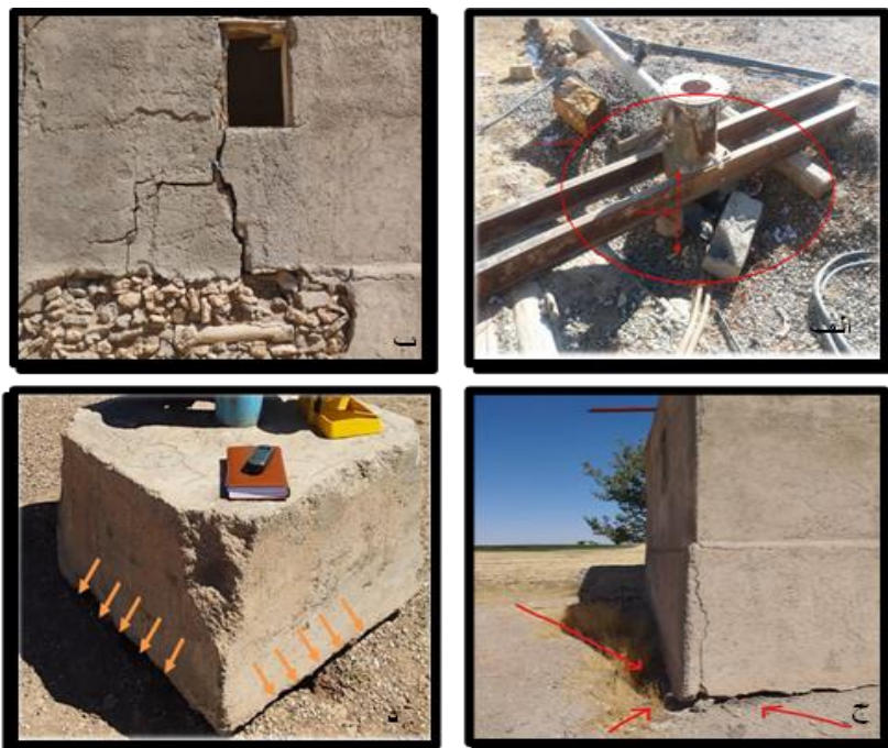
شکل ۹. الف) فرونشست سطحی در جداره لوله چاه بین دشت قروه و دهگلان (ب) ترک خوردگی در دیواره خانه چاه روستای کروندان (ج) نمایان شدن فرونشست در حاشیه خانه‌های مزرعه روستای کروندان (د) پایین رفتن سطح زمین و ارتفاع یافتن پایه‌های نمونه پایش فرونشست در روستای شهابیه
