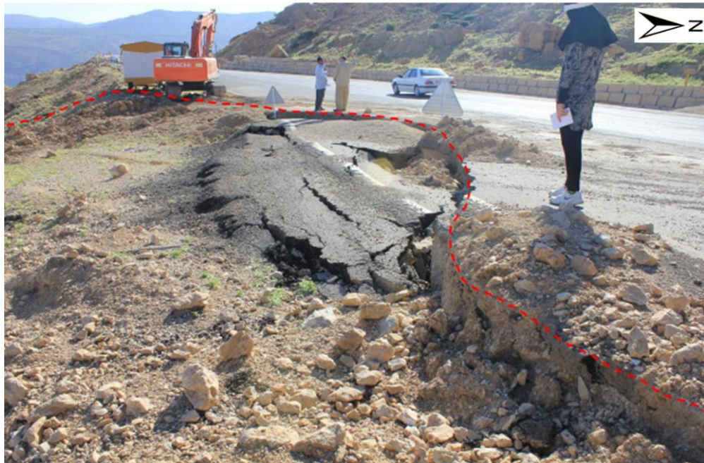
شکل ۱ عکس میدانی - نمونه‌ای از زمین لغزش حادث در مجاورت خط لوله
