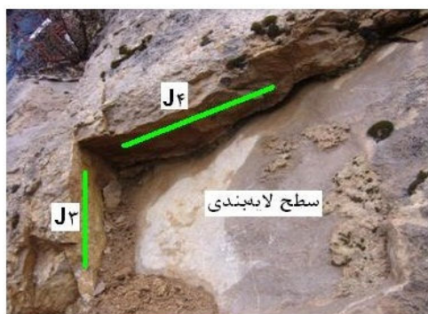
شکل ۸. سیستم درزه‌های J 3 ، J 4 و لایه‌بندی
