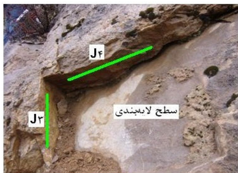
شکل ۸. سیستم درزه‌های J 3 ، J 4 و لایه‌بندی
