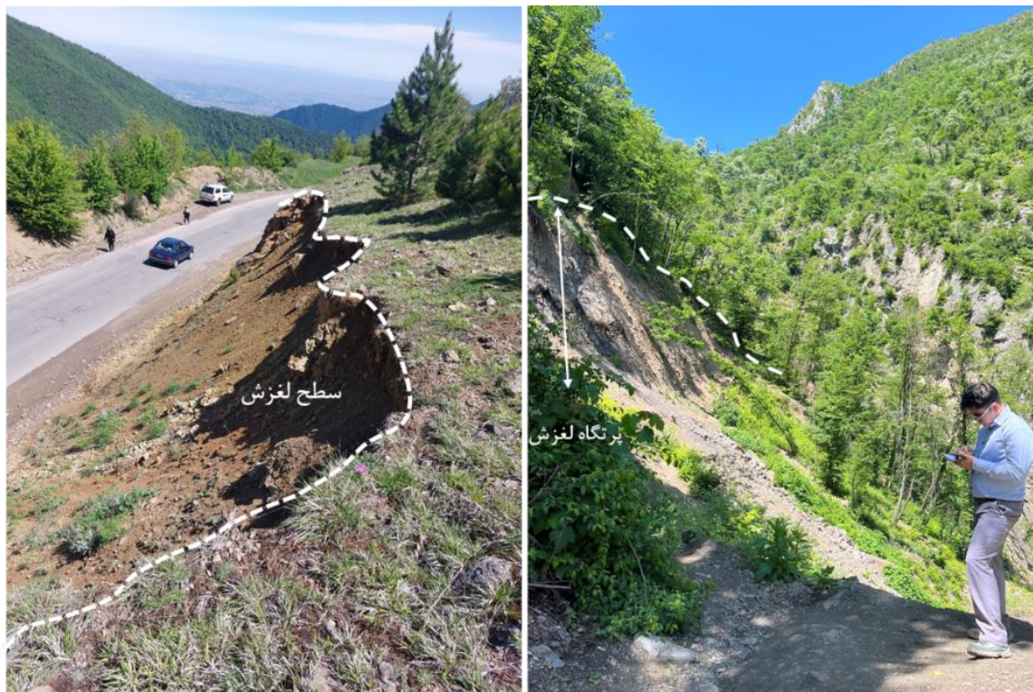
شکل ۱. تصاویری از برخی لغزش‌های رخ داده در مجاورت جاده توسکستان Fig. 1. Photographs of landslides that occurred in the vicinity of Tuskestan
