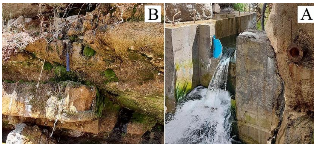
شکل ۱. A) نشت آب از زیر سد و B) نشت آب از تکیه‌گاه چپ سد قره‌تیکان.
