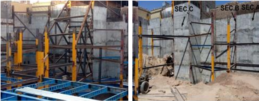
شکل ۱۰. الف) آسیب‌های وارده به ساختمان ۳ طبقه مجاور گود در مقطع C، ب) حفاری در مقطع C بدون نصب مهارهای کافی و افزایش روند صعودی تغییر شکل‌ها، ج) نصب مهارهای اضافی برای جلوگیری از افزایش تغییر شکل‌ها در مقطع C
