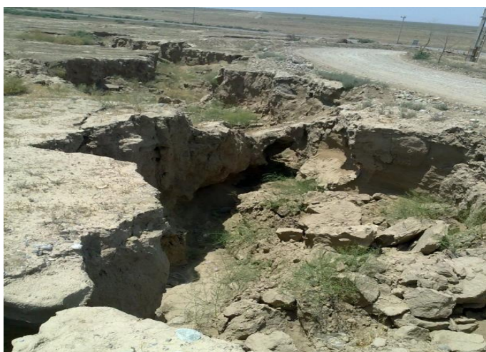
شکل ۱. تهدید و تخریب راه‌ها در اثر فرسایش لس‌های شهرستان کلاله، استان گلستان
