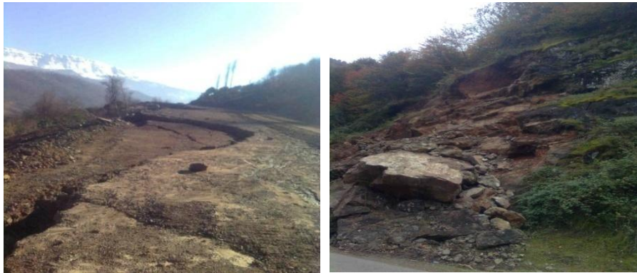
شکل ۳. نمایی از زمین‌لغزش‌های رخ داده در محدوده دریاچه سد در دست احداث پل رود
