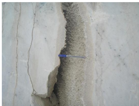
شکل ۸. تصویری از درز J10، این درز دارای دو نسل پرشدگی است و در حال حاضر در حال باز شدن است
