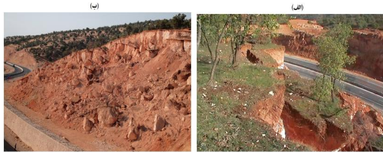
شکل (۲) لغزش داد آباد در ترانشه های مشرف به جاده بر اثر جاده سازی، کیلومتر ۲۲ جاده مطالعاتی، دید به جنوب غرب (الف)، لغزش آب بید به طول ۳۲۰ متر در دامنه های مشرف به جاده که باعث تغییر مسیر اصلی جاده و ایجاد پیچ تند شده است، دید به شمال شرق (ب)
