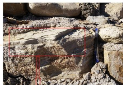
تخریب فیزیکی ناشی از هوازدگی نمک
